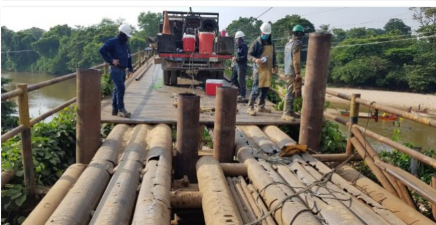
En las otras cinco infraestructuras se hará el remplazo de la rodadura en tubería. / Foto: PRENSA ECOPETROL
