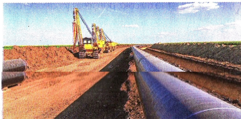
El sector trabaja bajo estrictas normas de seguridad y reiniciando algunas obras de construcción que habían quedado paralizadas. / Foto: iStock
