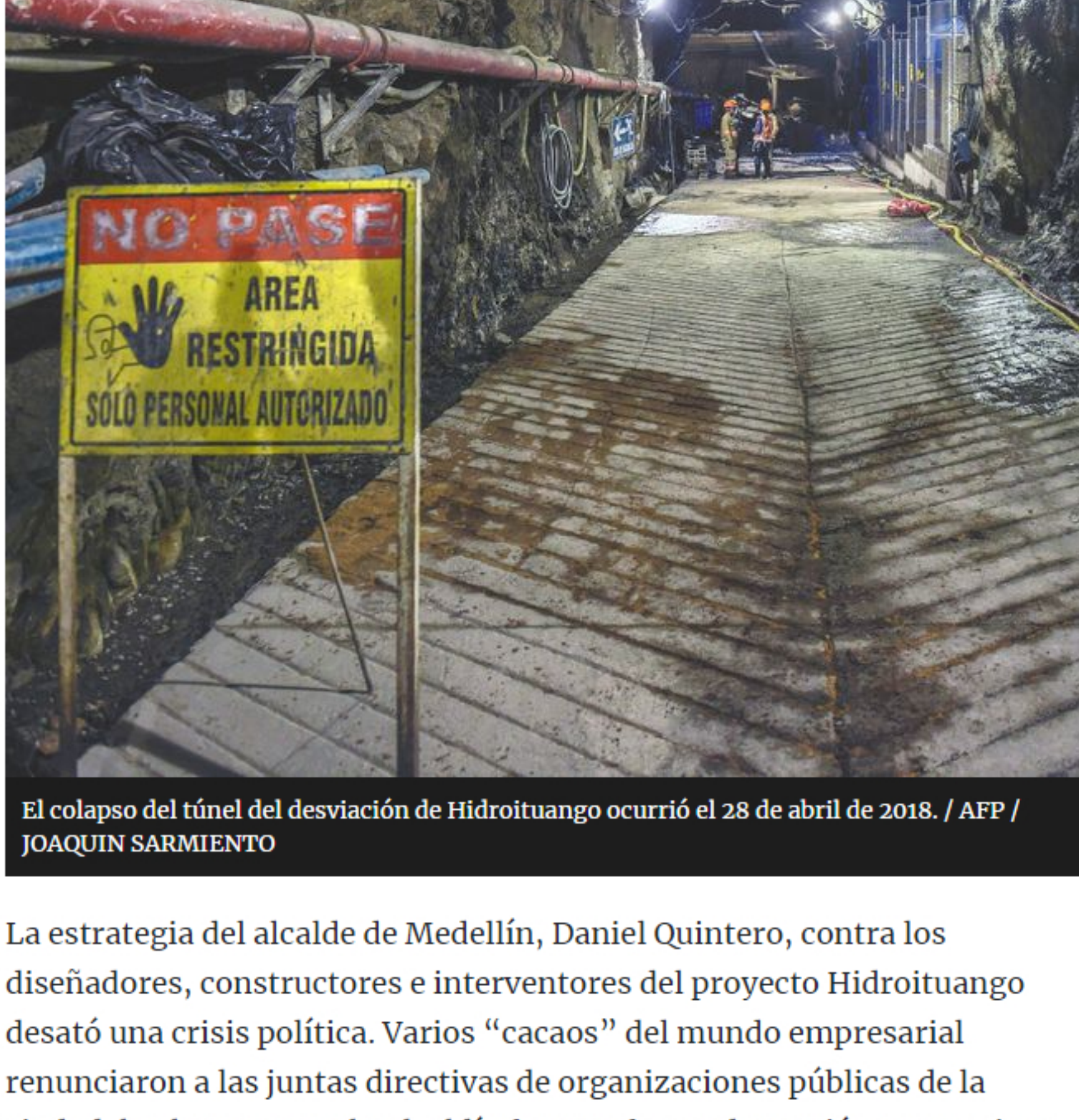
El colapso del túnel del desviación de Hidroituango ocurrió el 28 de abril de 2018. / AFP / JOAQUIN SARMIENTO
