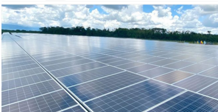
El Parque Solar Castilla, de Ecopetrol , se extiende en 18 hectáreas equivalentes a 16 canchas de fútbol/Twitter/ Ecopetrol /Archivo
