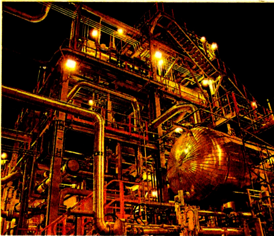
El complejo está integrado a la estructura del campo Cupiagua en el Casanare. Cortesía Ecopetrol
