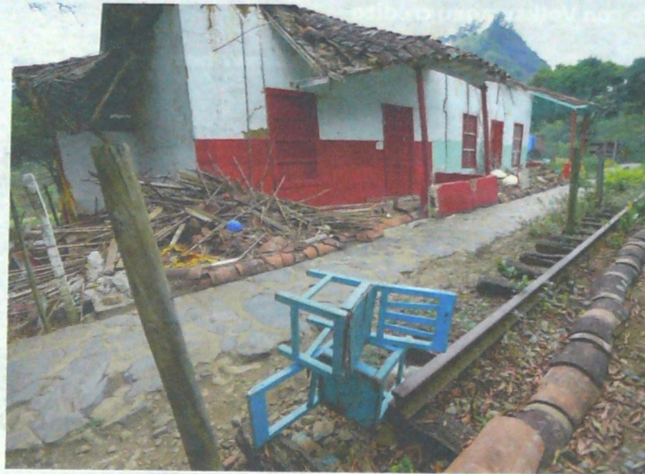
La estación Ancón del Ferrocarril de Antioquia (foto) fue una de las estructuras afectadas por la socavación del terreno. Aún se estudian las causas de la emergencia. FOTO JULIO CÉSAR HERRERA
