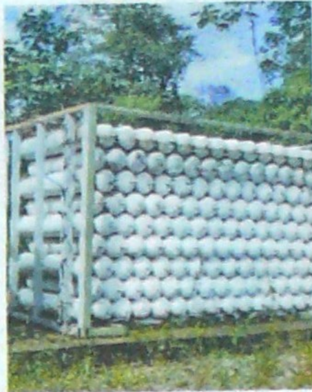
ESTACIÓN DESCOMPRESORA y sistema de almacenamiento de Itmina/CGR
