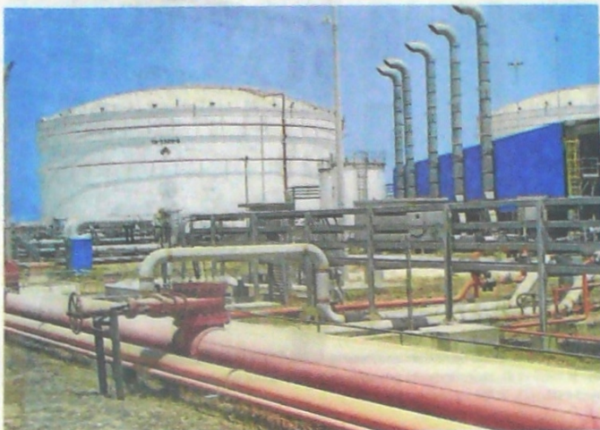
Hoy Puerto Bahía tiene 8 tanques de almacenamiento de hidrocarburos, cada uno con una capacidad de 330 mil barriles y con áreas disponibles para expansión. // FOTO HFA - EL UNIVERSAL
