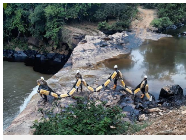
BLU Radio. Oleoducto Caño Limón-Coveñas // Foto: Ecopetrol
