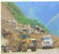
Derrumbe en vía al Llano.
