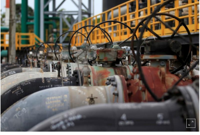
Foto de archivo: Instalaciones de Ecopetrol en el campo petrolero Castilla, en Castilla La Nueva, Colombia, 26 de junio, 2018. REUTERS/Luis González
