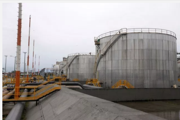
Foto de archivo. Tanques de almacenamiento de petróleo en la planta Ecopetrol en Castilla La Nueva, Colombia. 26 de junio de 2018.
