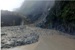
En los últimos días la situación de la vía Bogotá-Villavicencio se ha complicado debido a las fuertes lluvias.
