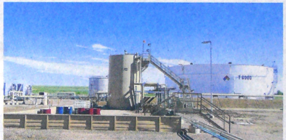
El agua contaminada del proceso se almacena en grandes tanques antes de volver a la tierra.
