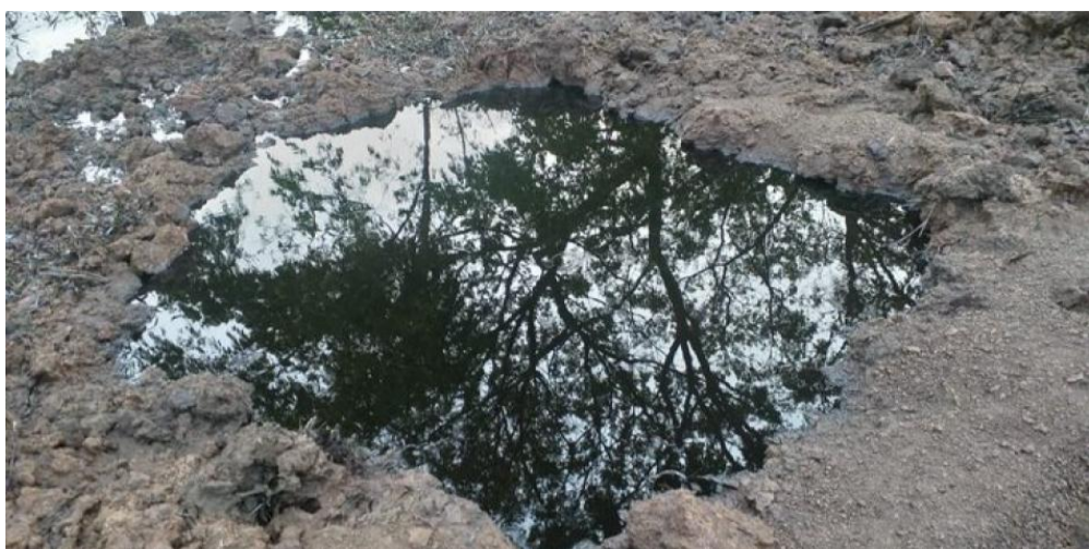
Rotura en la línea de transferencia del fluido de petróleo en Caño Limón, originada por un ataque con explosivos el 7 de junio de 2019. Foto: Cortesía de Ecopetrol
