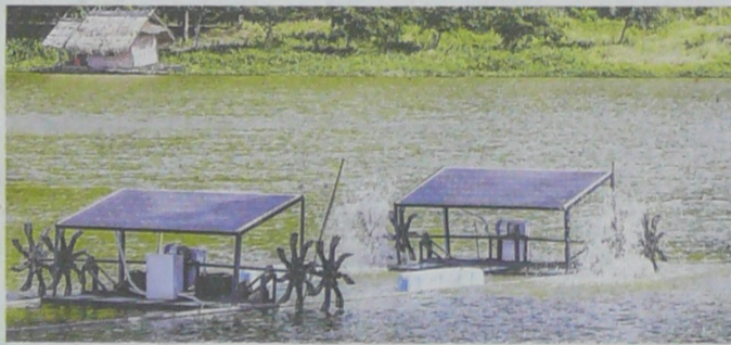
Según la Ley 1715 de 2014, en Colombia pueden usarse varios sistemas de energía renovable. Algunos de ellos pueden conectarse a la red eléctrica convencional.
