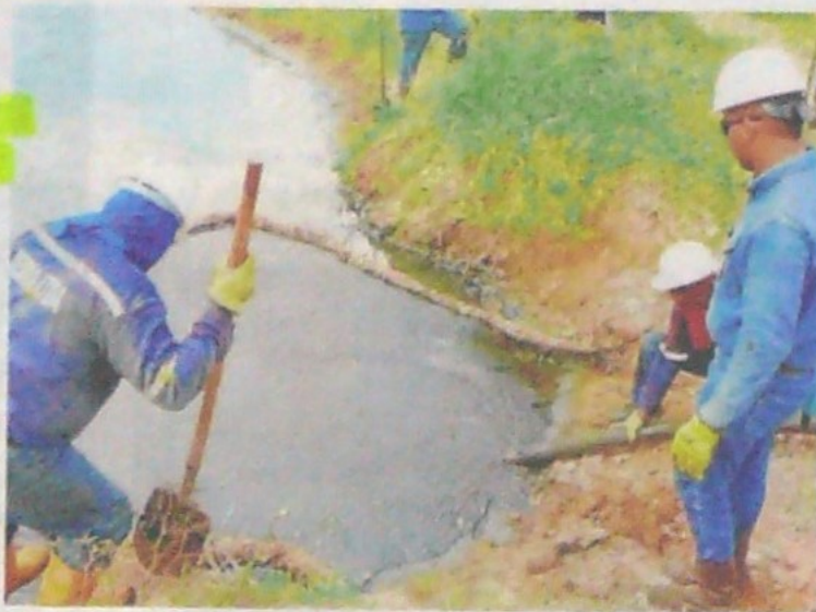
La contingencia se presentó el 30 de julio, de inmediato cuadrillas de limpieza iniciaron trabajos de recuperación del afluyente. / FOTO: ARCHIVO, Q'HUBO
