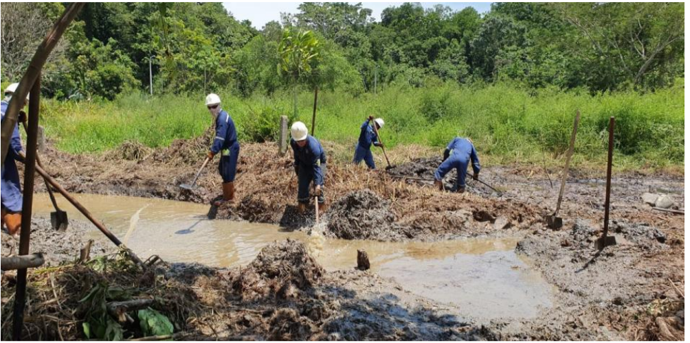
Ecopetrol activó un plan de contingencia para realizar las respectivas labores de limpieza en la zona. Foto: Cortesía de Ecopetrol
