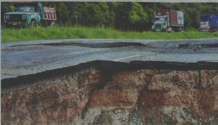
La mayor complicación en las vías del Valle se presenta en el kilómetro 89 entre Loboguerrero y Buga por la caída de la banca. Pese a esto no se ha suspendido la movilidad, pero sí hay tráfico restringido.
