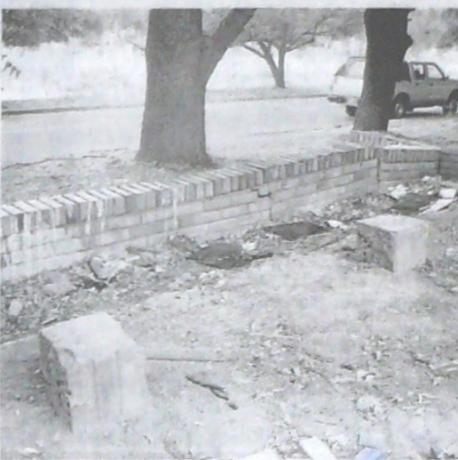
LOS MUROS DEL PARQUE se caen a pedazos por la falta de mantenimiento e inversión.
